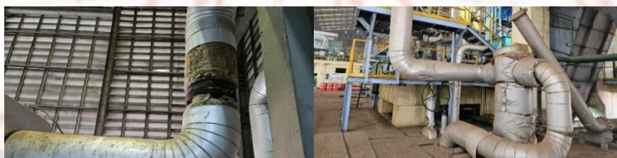
ภาพที่ 4-3 ท่อน้ำร้อนที่ไม่มีฉนวนบุ (ซ้าย) และท่อน้ำร้อนที่ใช้ฉนวนบุท่อ (ขวา)
