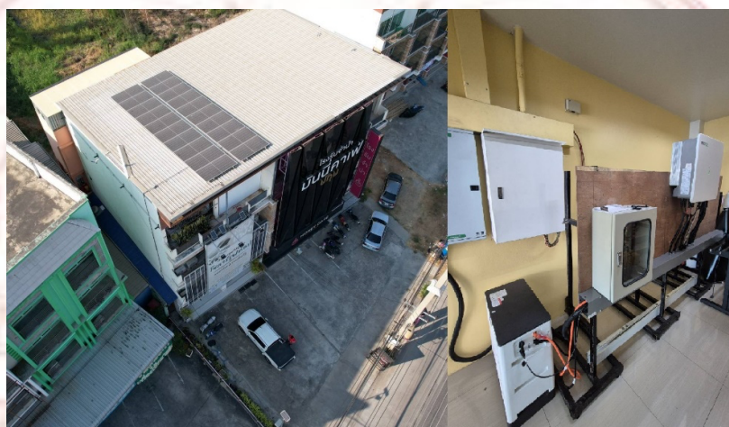
รูปที่ 4.1 ระบบผลิตไฟฟ้าพลังงานแสงอาทิตย์แบบผสมผสานติดตั้งจริงในอาคารสำนักงาน แสดงให้เห็นการติดตั้งแผงโซลาร์เซลล์บนหลังคา และอุปกรณ์ควบคุมภายใน ได้แก่ อินเวอร์เตอร์ ตู้ควบคุม และแบตเตอรี่สำรองพลังงาน
