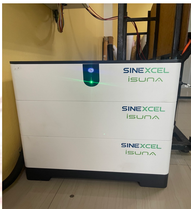
รูปที่ 3.5 แสดง แบตเตอรี่ ที่ใช้กับระบบ Solar Hybrid System.
