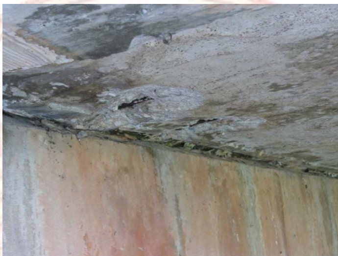
ภาพที่ 2-14 ภาพแสดงการหลุดร่อนใต้แผ่นพื้นสะพาน
