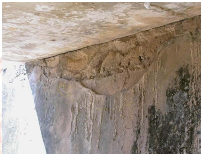
ภาพที่ 2-12 ภาพแสดงการหลุดเซาะบริเวณคานขวางของตอม่อสะพาน
