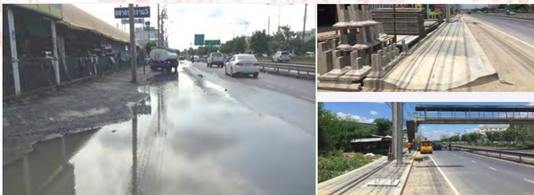
ภาพที่ 2-8 ภาพประกอบการดำเนินการก่อสร้างระบบระบายน้ำและทางเท้า
