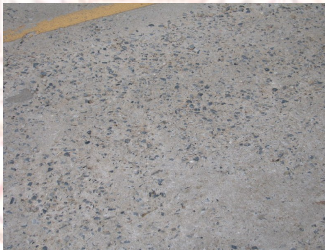
ภาพที่ 2-17 ภาพแสดงการสึกหรอของผิวคอนกรีต
