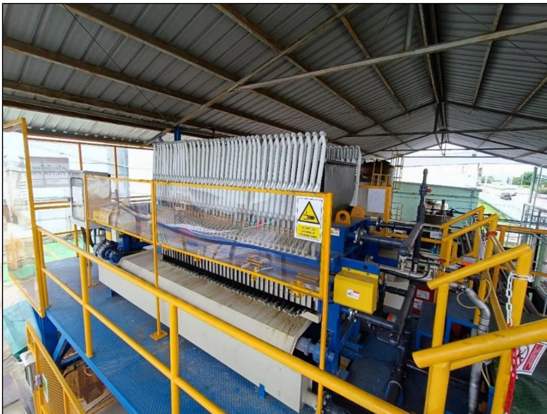
ภาพที่ 4-8 เครื่องรีดตะกอนของระบบบำบัดน้ำเสียโรงงานผลิตที่ 1
