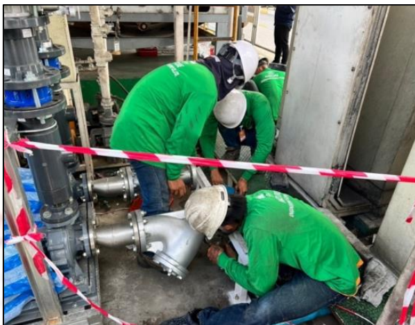
ภาพที่ 3-13 ภาพการดำเนินงานติดตั้งปั้มน้ำเสีย EBARA รุ่น 65x50 FS2HA5 ที่บริเวณระบบบำบัดน้ำเสียของโรงงานผลิตที่ 2
